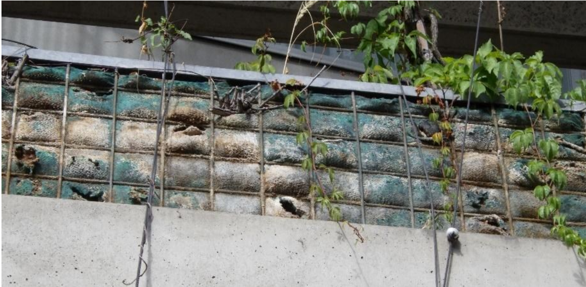
Abbildung 36: Beispiel für zu ersetzendes Material aufgrund von Materialermüdung (Bildquelle: TU Wien, 2019)
